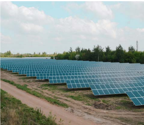
Photovoltaikanlage in Leipzig/Wiederitzsch
