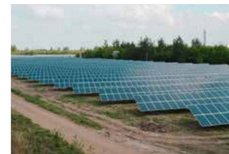
Photovoltaikanlage in Leipzig/Wiederitzsch
